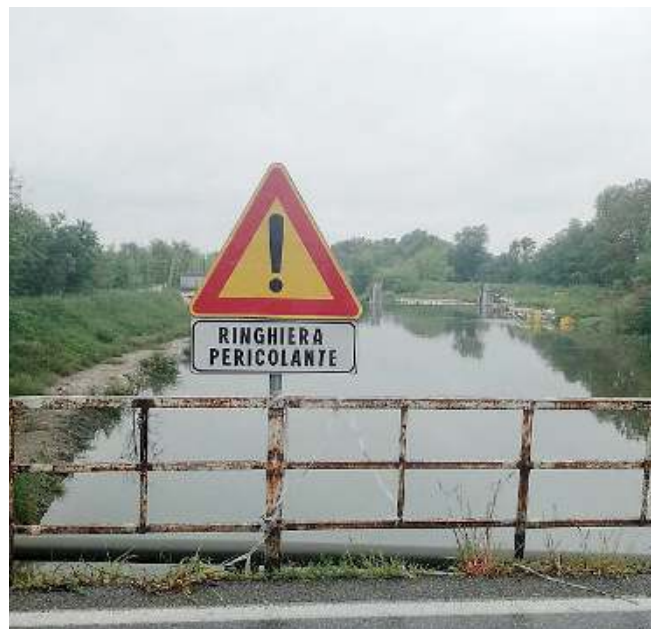
Pericolo. La segnalazione della ringhiera pericolosa sul ponte
